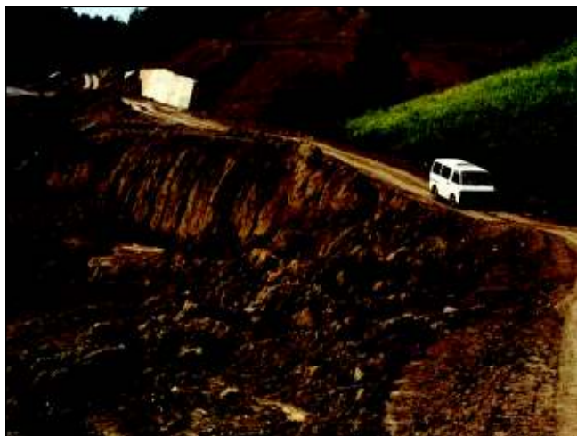
Slika broj 5 - Klizište
