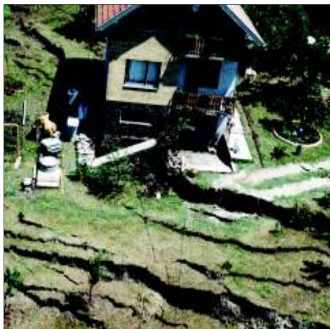
Slika broj 2 - Klizište
